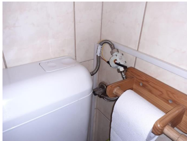
Fig. 60 Senzor de debit instalat la alimentarea cu apă a toaletei
