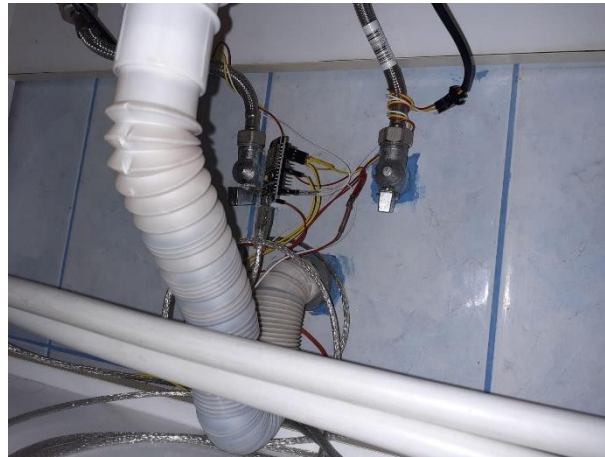
Fig. 59 Modul de achiziție instalat sub chiuvetă
